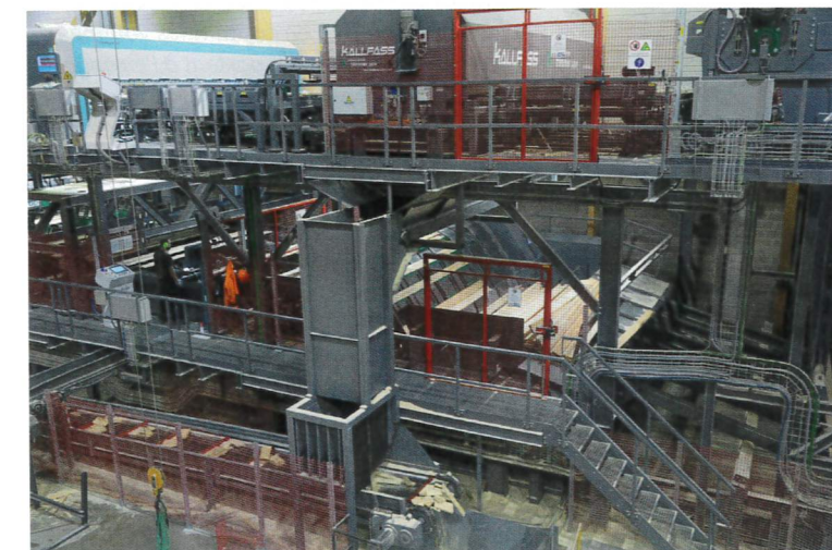
Le scanner Microtec Goldeneye est intégré en aval de la ligne en amont du trimmer et collecte des informations cruciales pour optimiser le process de sciage en plus de participer au tri-classement. Photo: F. Hermann
